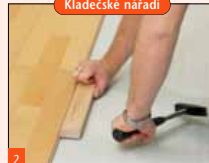
2 Podbíjecí špalík z tvrdého dřeva chrání citlivá pera podlahových prvků. Přípravek se musí pevně přiložit, dřívě než se udeří kladem.
